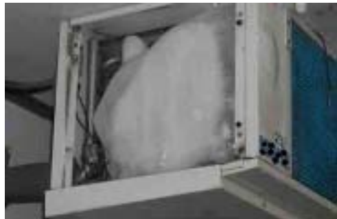
Fig.1 Bloque de hielo en evaporador
