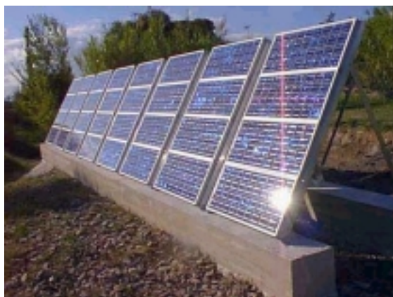
Figura 6.3 – Painéis solares fotovoltaicos
