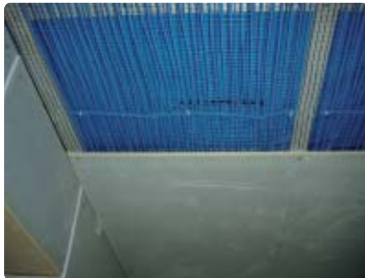
Figura 2.- Malhas capilares sobre guias e sob lã rocha em tecto falso de gesso.
