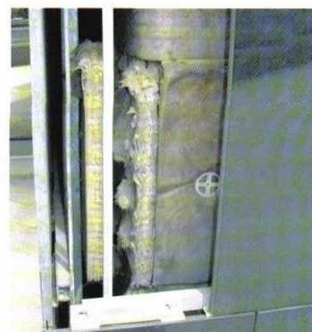
Revestimento independente descontínuo com interposição de isolante térmico na caixa de ar, imagem do Guia técnico da Reabilitação Habitacional, pág. 431.
