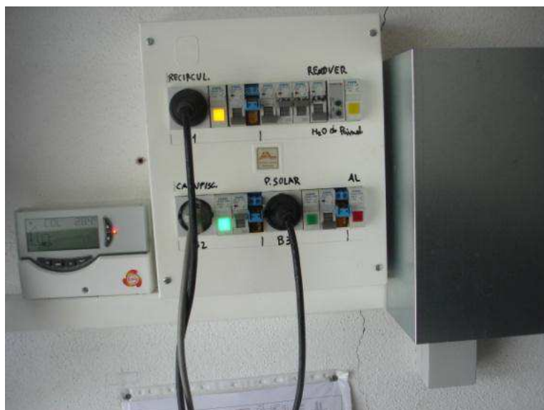
Centralina, quadro eléctrico e auto-transformador
