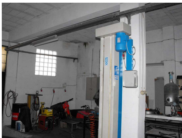
Quadro abastecimento/geral ao fundo
