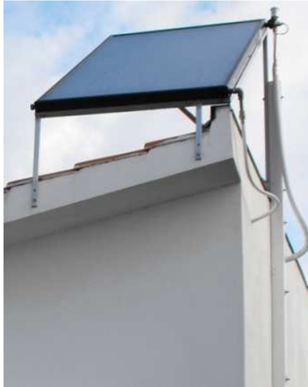
Imagem 4.8 - Pannel solar fixado em 3 pontos evitando a furação do telhado
