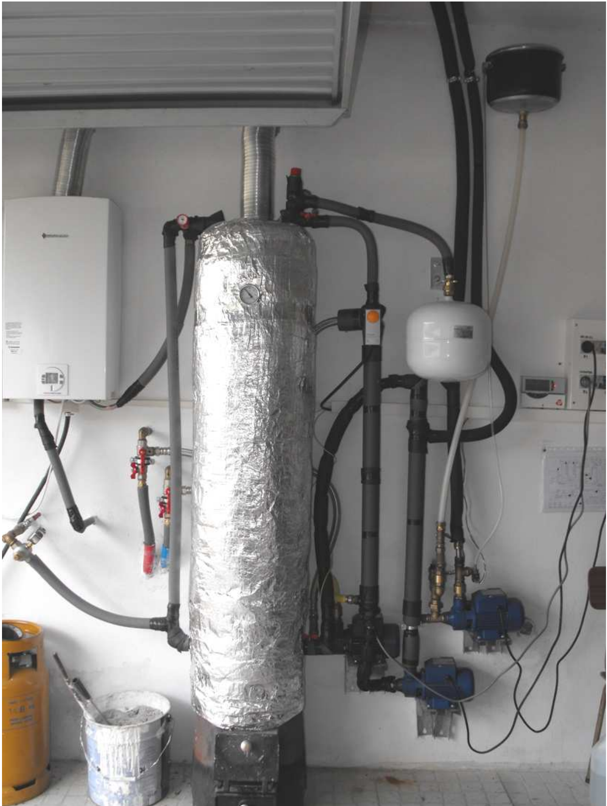
Imagem 4.7 - Sistema de aquecimento instalado
